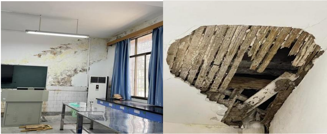
护理学院实验室墙壁和屋顶情况
